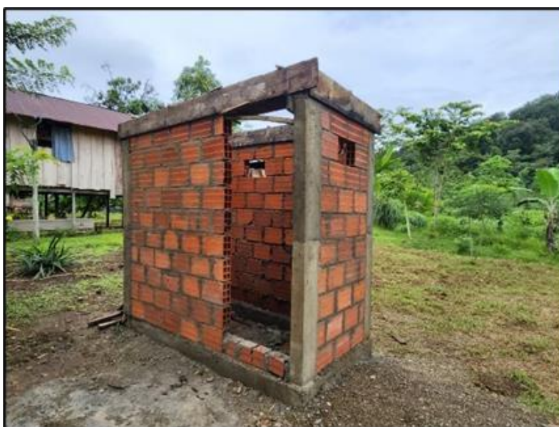
Comunidad Llano – Instalación sanitaria
